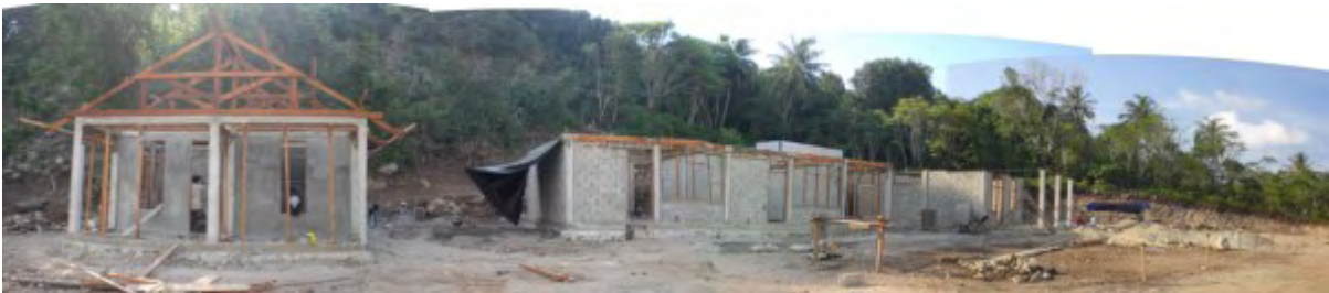
23 Mai 2008 : Tous les murs de l'école sont terminés. La charpente de la maison est assemblée.
