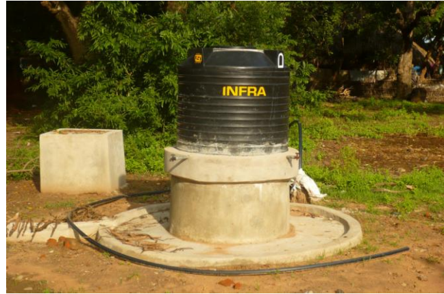
Réservoir type d'eau potable de 2000 Litres à V.Kenipet
